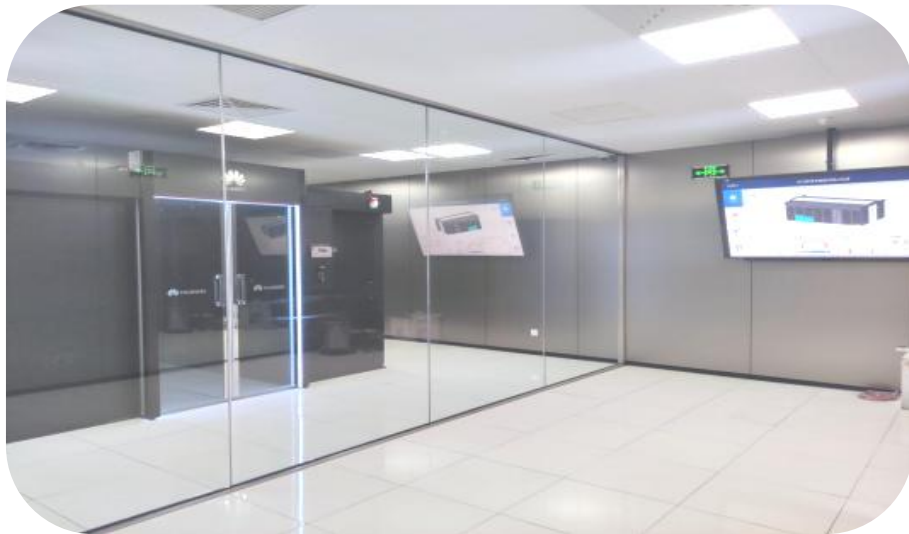
图 3 校园数据中心
